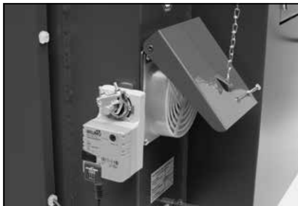
Die Klappe für die Verbrennungsluftzufuhr in den Kessel geöffnet (eingestellt)
